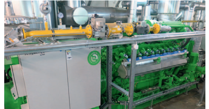
Bild: © Stadtwerke Fürstenfeldbruck – Neues Modul 2 in der Obermühle: Ein 20-Zylinder-Gasmotor treibt den Stromgenerator an, mit dem eine Effizienzsteigerung von annähernd 10 Prozent im thermischen und elektrischen Wirkungsgrad erreicht wird.
